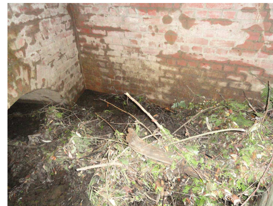
Bild 2 - Blick in den vorh. Zulaufschacht, stark verkleust
